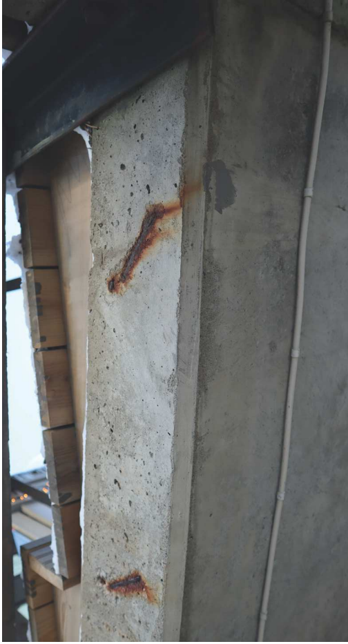
Betonin raudoituksia on näkyvissä.
